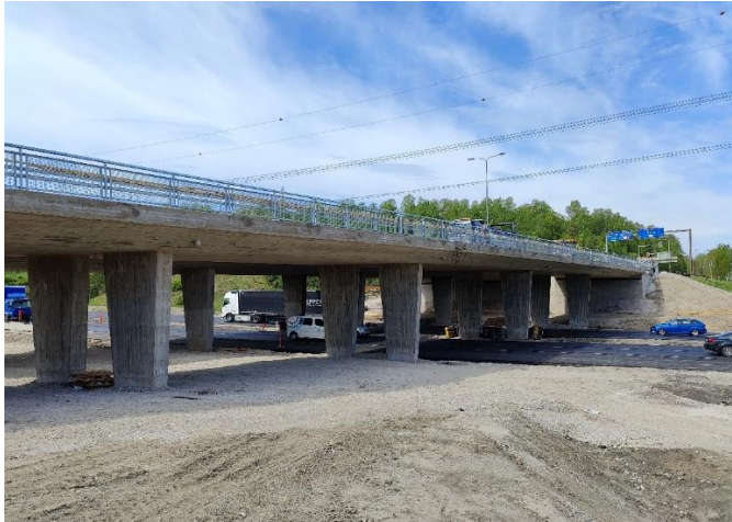
Kuva 1. Sillan S112 sääsuoja on purettu ja kansi päällystetty. Silta on valmis viimeistelyitä lukuun ottamatta.
