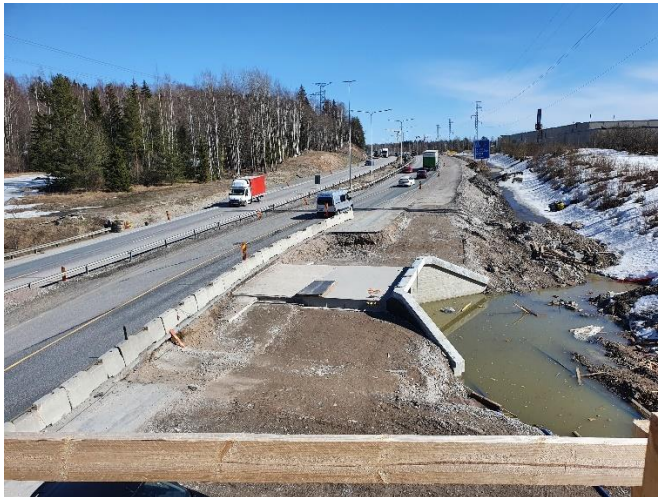
Kuva 2. Sillan S107 alikulku täynnä vettä ja pumppaus käynnissä.
