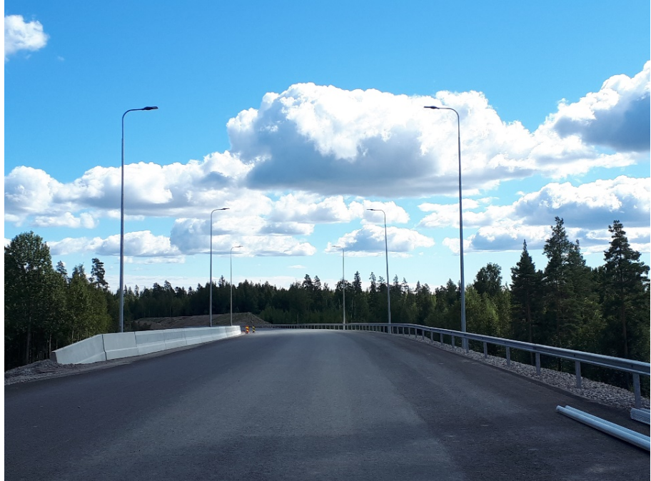
Kuva 4. Lähellä Metsäkyläntien risteyssiltaa on asennettu valaistusta, melukaidetta ja pengerkaidetta 27.8.2020
