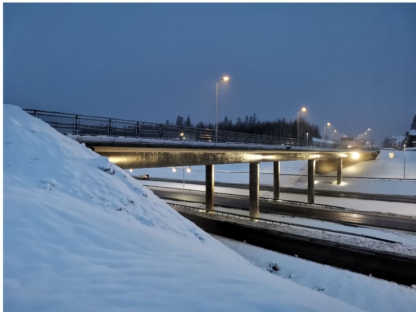
Kuva 1. S5 sillan erikoisvalaistus asennettu, kuva 27.1.2021
