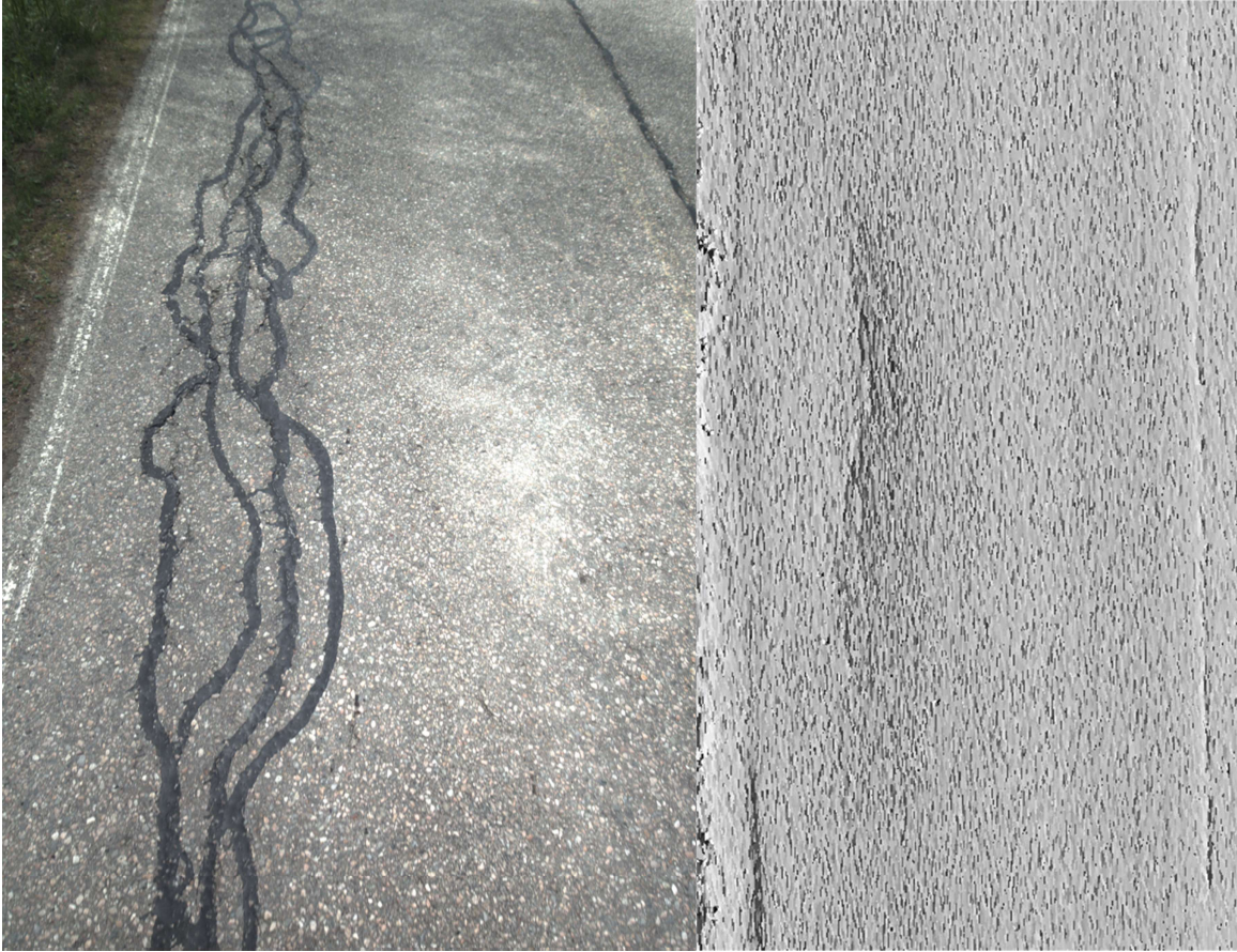
Kuva 17. Painuma-alue murtumineen ja päällystesauma ovat tunnistettavissa rinnevarjostetusta pistepilviaineistosta (oikealla).
