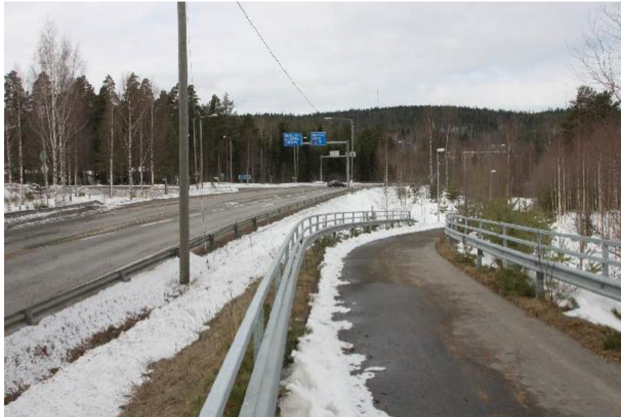
Kuva 18. Uuraistentien (mt 6304) liittymän toimivuutta haittaa ajoradan yli 5 %:n pituuskaltevuus. Viereisellä kevyen liikenteen väylällä pituuskaltevuus on 7,5 % ja nousu alikulusta Uuraistentien suuntaan on vielä jyrkempi.
