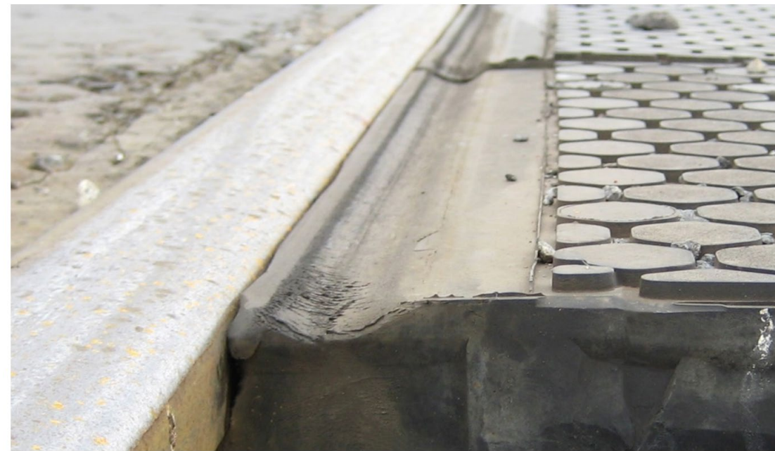
Kuva 21. Laippaurattomuus noin 5 vuoden käytön jälkeen Turun asemalla - yliajoja on satoja akseleita päivittäin
