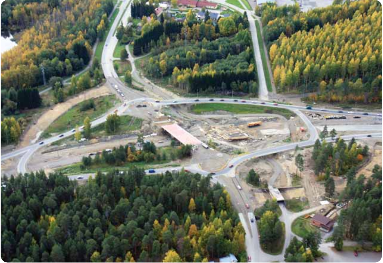
Kettuvaaran eritasoliittymässä työnaikainen liikenne ohjattiin ramppien kautta sekä kehätien suunnassa että Kettuvaarantien suunnassa. Kuva syyskuulta 2011.
