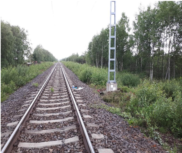
SIGNALOINTI ENNEN MOBIILIKEILAUSTA
